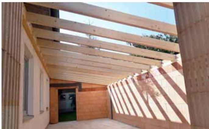
Für Ausrüstungsgegenstände und das Inventar der Feuerwehr stehen zukünftig 48 Quadratmeter zusätzliche Lagerfläche zur Verfügung. (Fotos: Schrödl)
