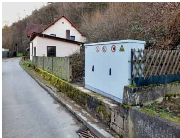
Die neue Abwasserpumpstation in Sulzbach am Waldweg
